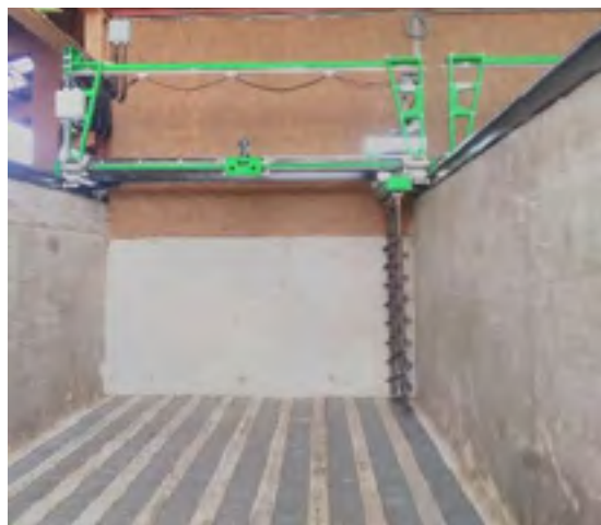
Mélangeur installé chez le GAEC Duthoit Philippoteaux sur une case mixte. La vis tourne et se déplace de part et d'autre du tas puis avance.
